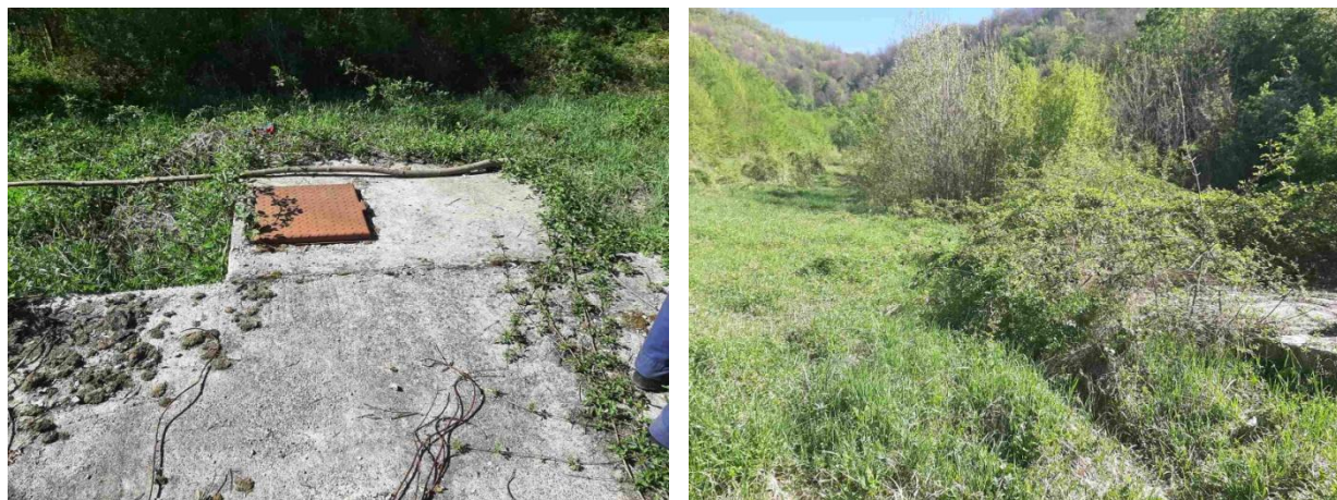
Slika 6-2: Vodozahvatni objekat izvorišta Paljevo
